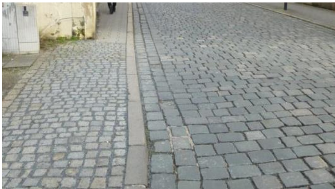
Abbildung 50: Flächiger Mangel im Bereich Badstraße/Münzgasse (Richtung Osten)
